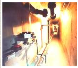
RED DE CONTROL DE INFILTRACIONES
