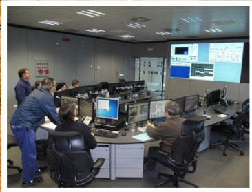
SALA DE CONTROL
