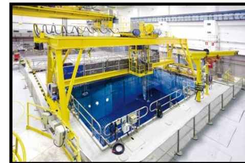
Piscina de elementos combustibles irradiados
